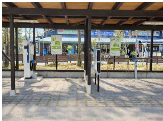
電気自動車・電気バイク充電設備
