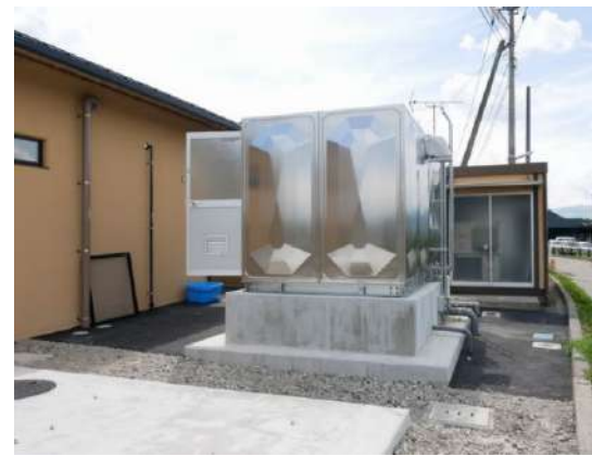
受水槽(断水時も利用可)
