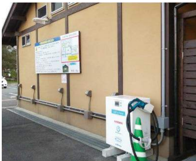
無料電源供給設備
